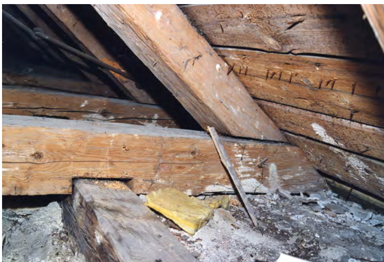
Figur 3.16 Glipa mellan stickbjälke och yttre murren. Tingsås kyrka, västra sidan.
