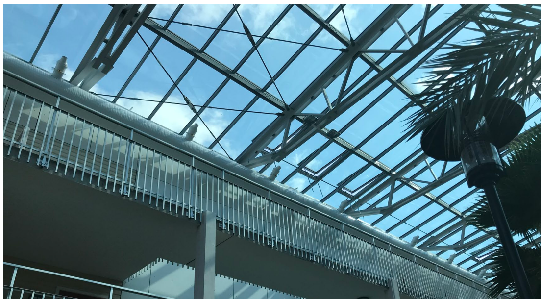
Figur 4.4. Mekanisk ventilation motverkar kondens på insida glastak.
