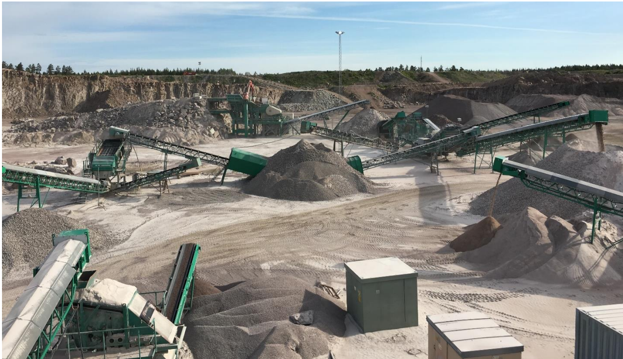
Figure 1. Two stage crushing plant. (Swerock, Vändle Bergtäkt)
