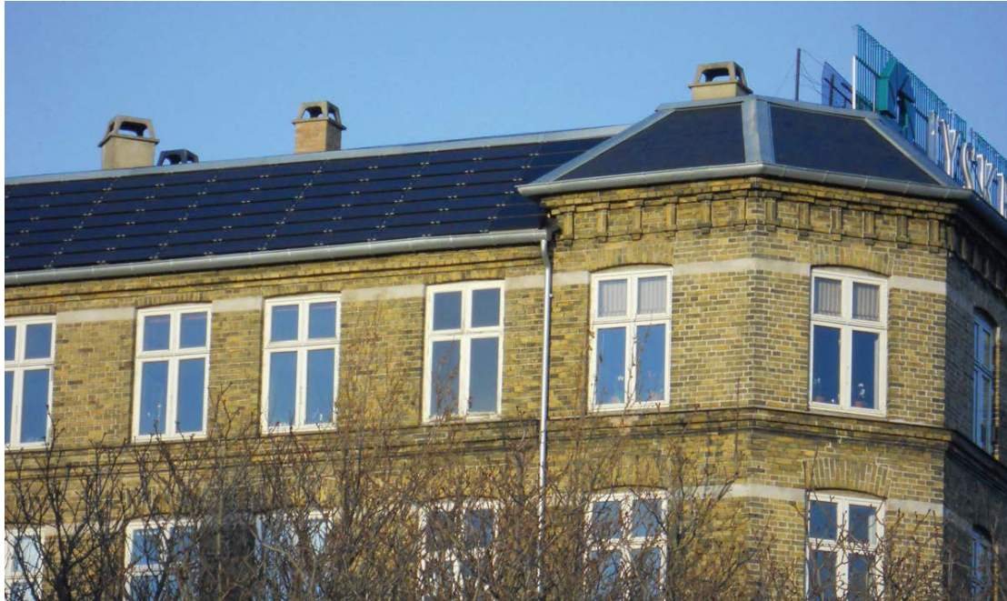
Figur 9. På höger sida ses den befintliga taklösningen och på vänster ligger solceller. Integreringen har utgått från hänsyn till byggnadens rytm och linjer. Foto: Københavns Kommune (2013), taget i Søpassagen i Köpenhamn.
